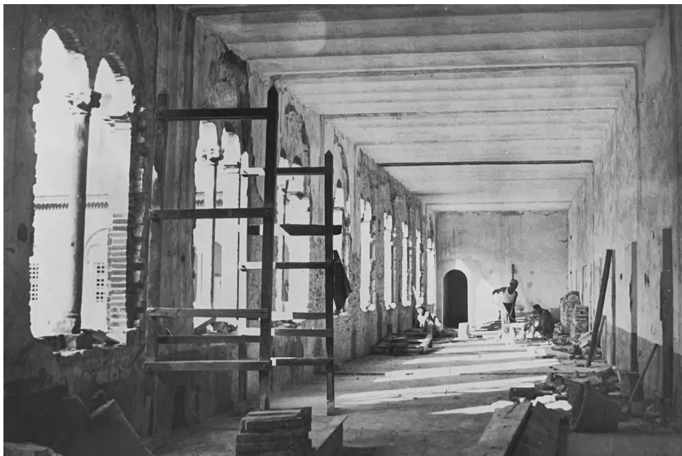
Fig. 3 Pisa, Complesso conventuale di San Matteo. Galleria del primo piano durante i lavori di restauro, febbraio 1946 (© Ministero della Cultura / Soprintendenza ABAP di Pisa, Archivio fotografico).
