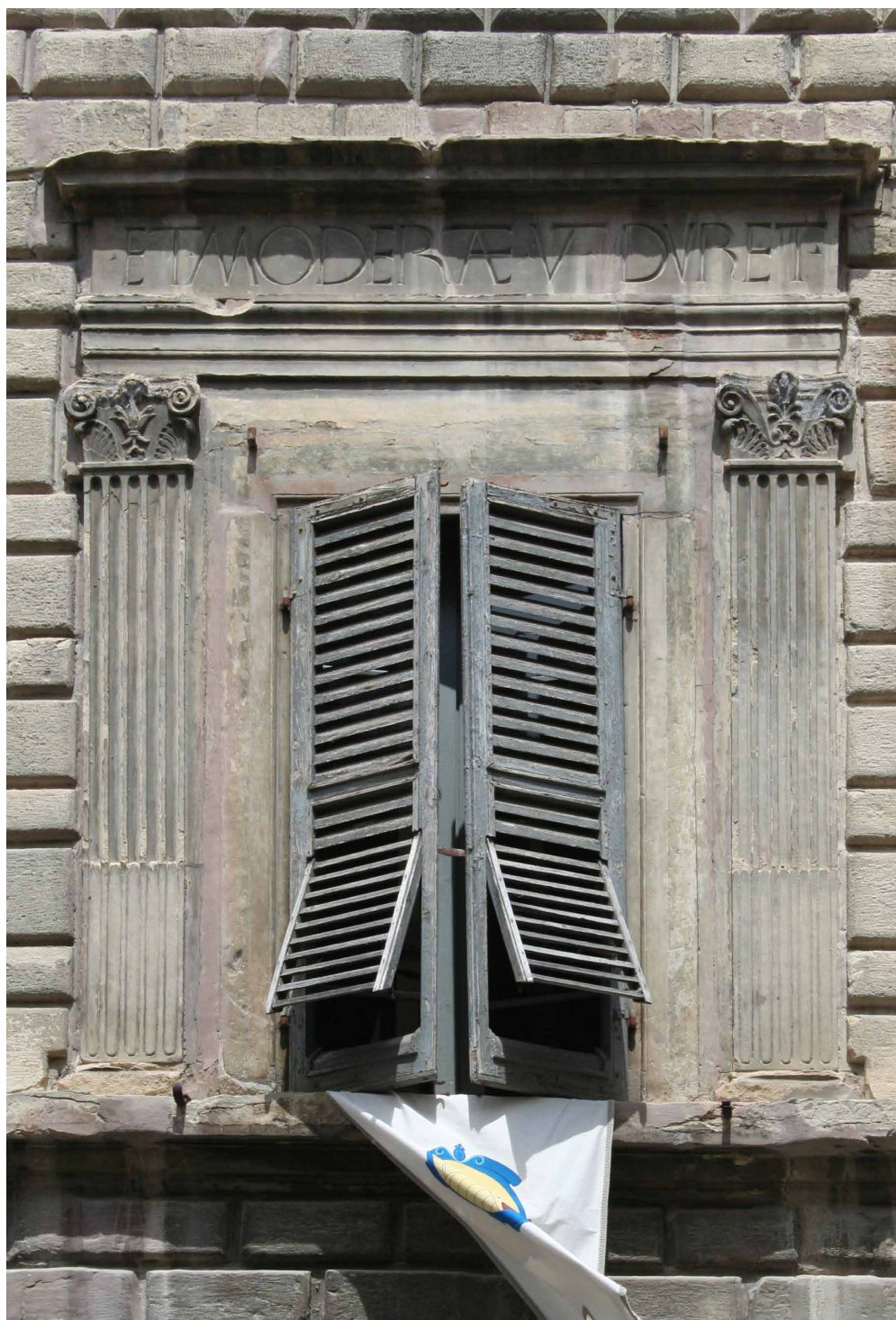
Fig. 5 Palazzo Dedi-Staurenghi, Fossombrone. Finestra a edicola trabeata del piano nobile prima dei restauri (foto G. Aureli).
