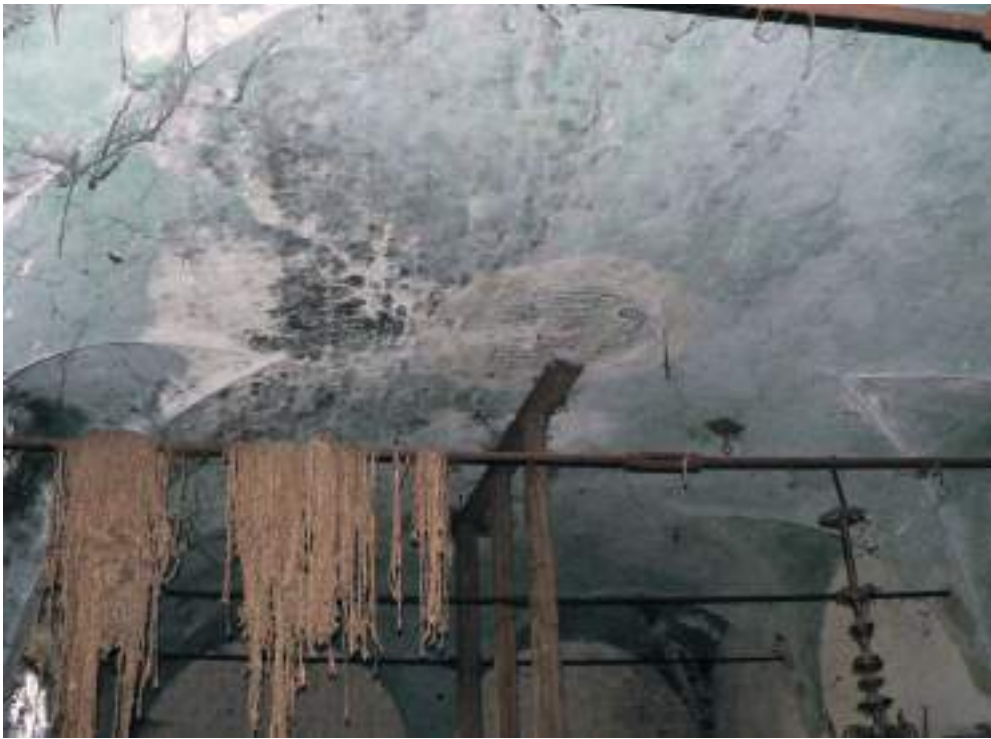
Fig. 4 Caselle Lomellina, Pavia. Volta affrescata dell'ambiente a pianta quadrata al piano terreno.
