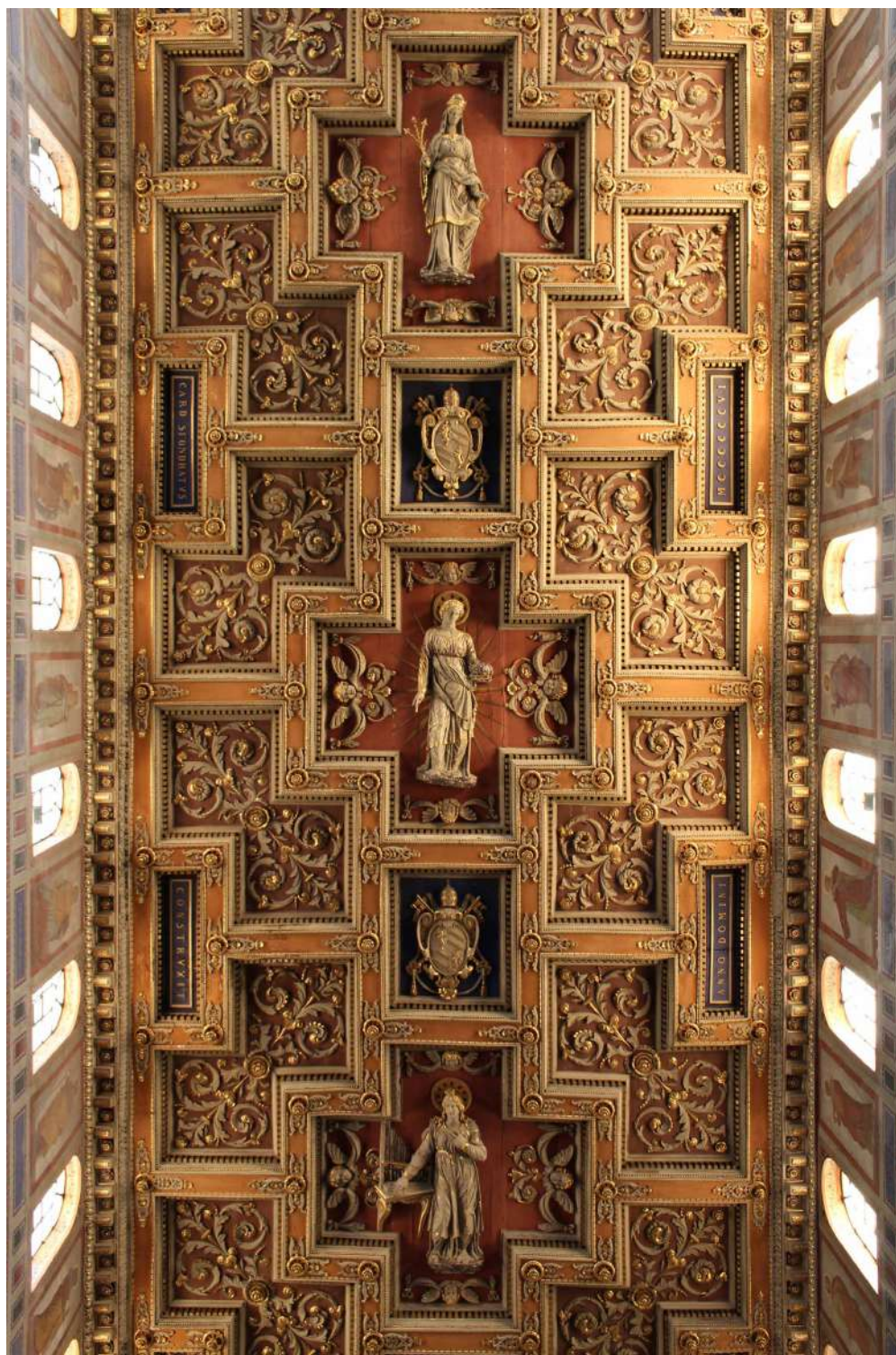
Fig. 8 Soffitto della chiesa di Santa Agnese fuori le mura, Roma (foto L. Grieco).
