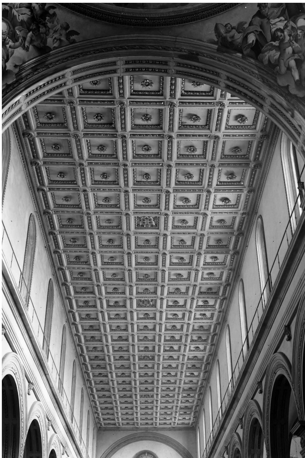
Fig. 1 Chiesa di San Marco al Campidoglio, Roma. Veduta della navata centrale (Roma, fototeca Bibliotheca Hertziana).
