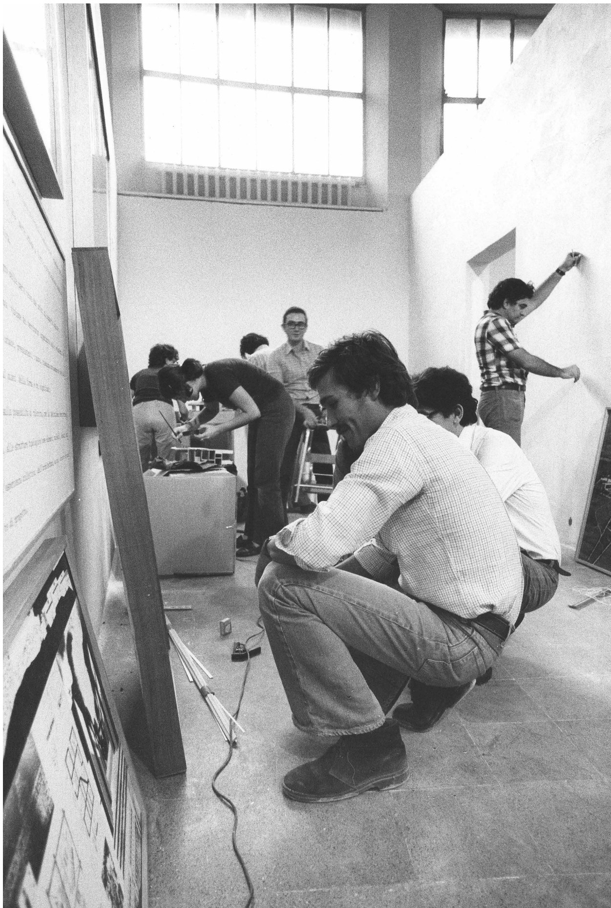
Fig. 3 Vista di uno degli ambienti durante i lavori di allestimento della mostra. In primo piano, accovacciato, Gianni Braghieri (foto V. Castelli; Milano, collezione privata).
